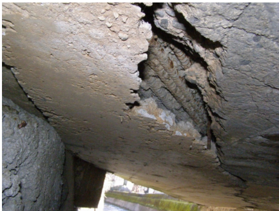
写真-1.1 コンクリート床版の鉄筋露出
