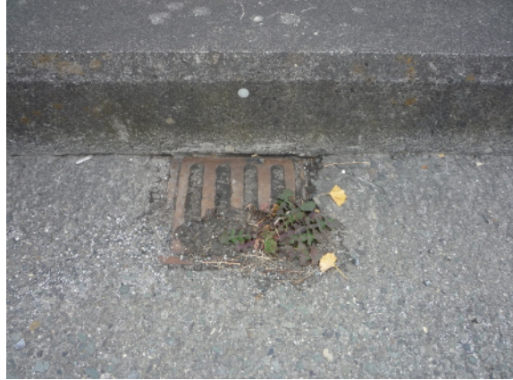
排水ますの土砂詰り
