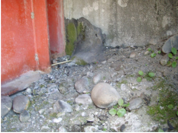
橋の端部土砂堆積
