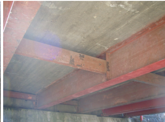
写真-1.2 鋼桁の防食機能の劣化
