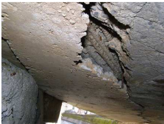
写真-1.1 コンクリート床版の鉄筋露出
