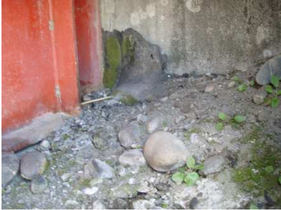
橋の端部土砂堆積
