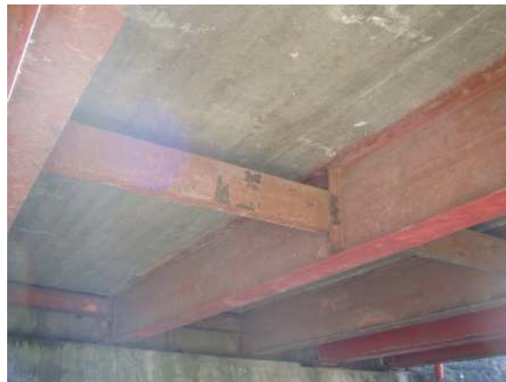
写真-1.2 鋼桁の防食機能の劣化
