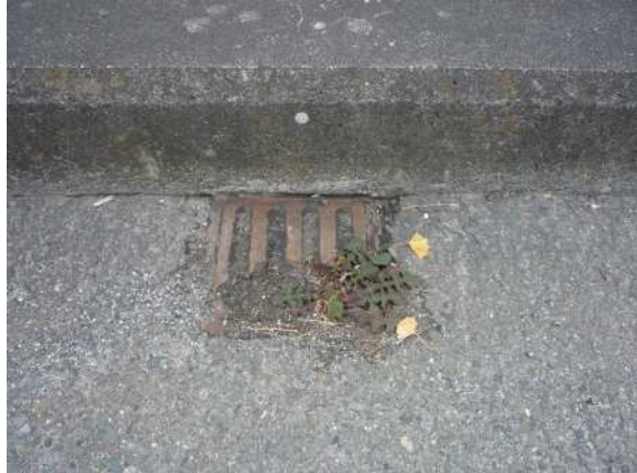
排水ますの土砂詰り
