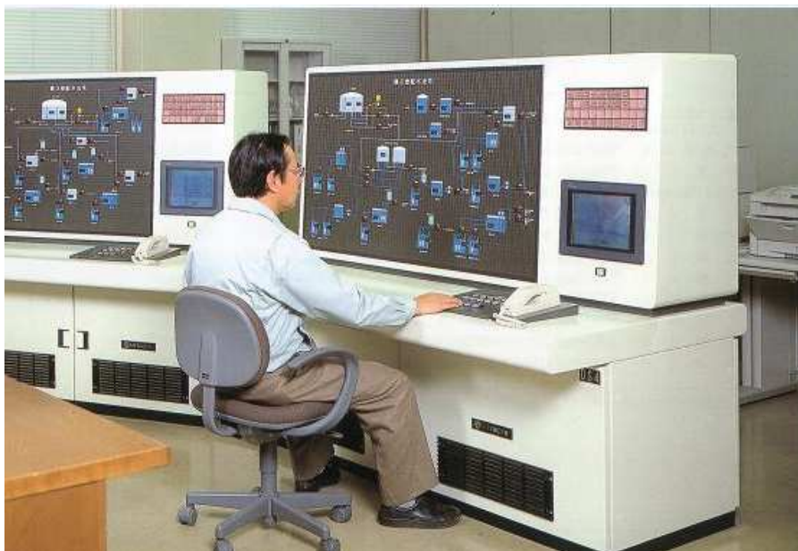
市役所上下水道課の集中管理室で、多数の施設を一元管理しています
