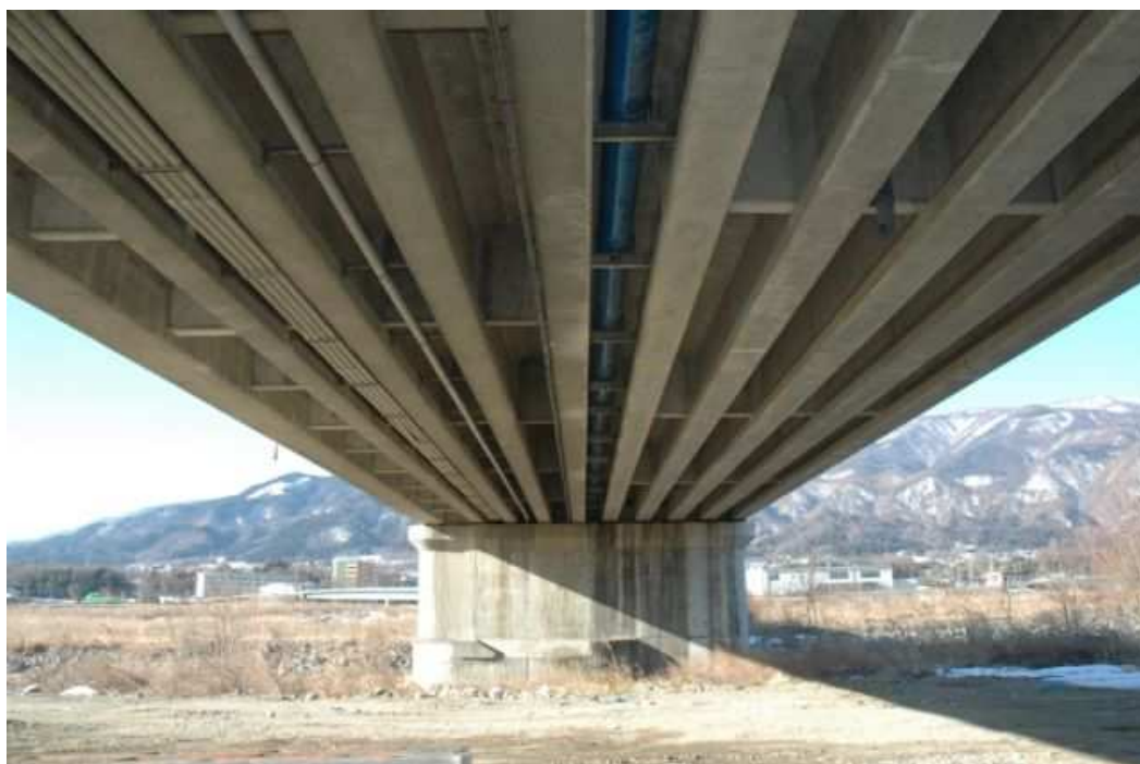
甘利地区への送水管（武田橋）
