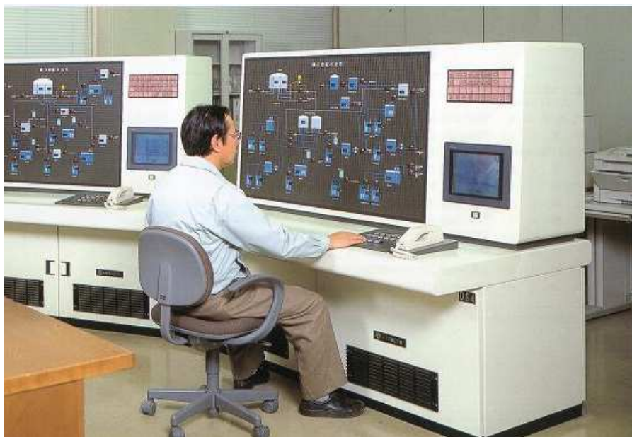
市役所上下水道課の集中管理室で、多数の施設を一元管理しています
