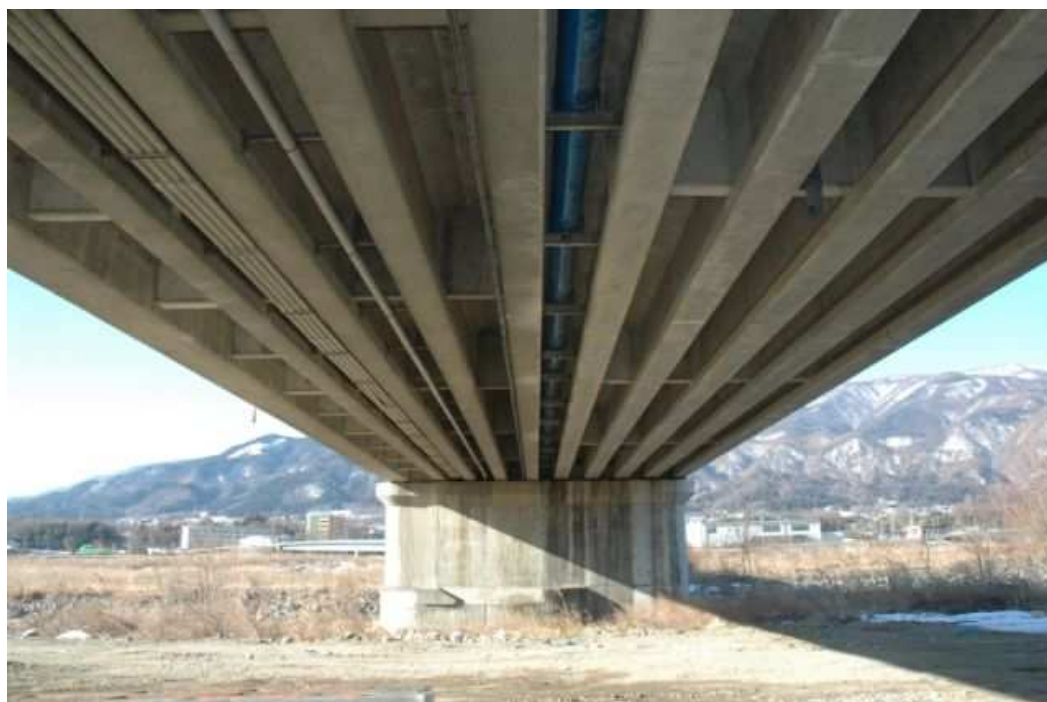
甘利地区への送水管（武田橋）
