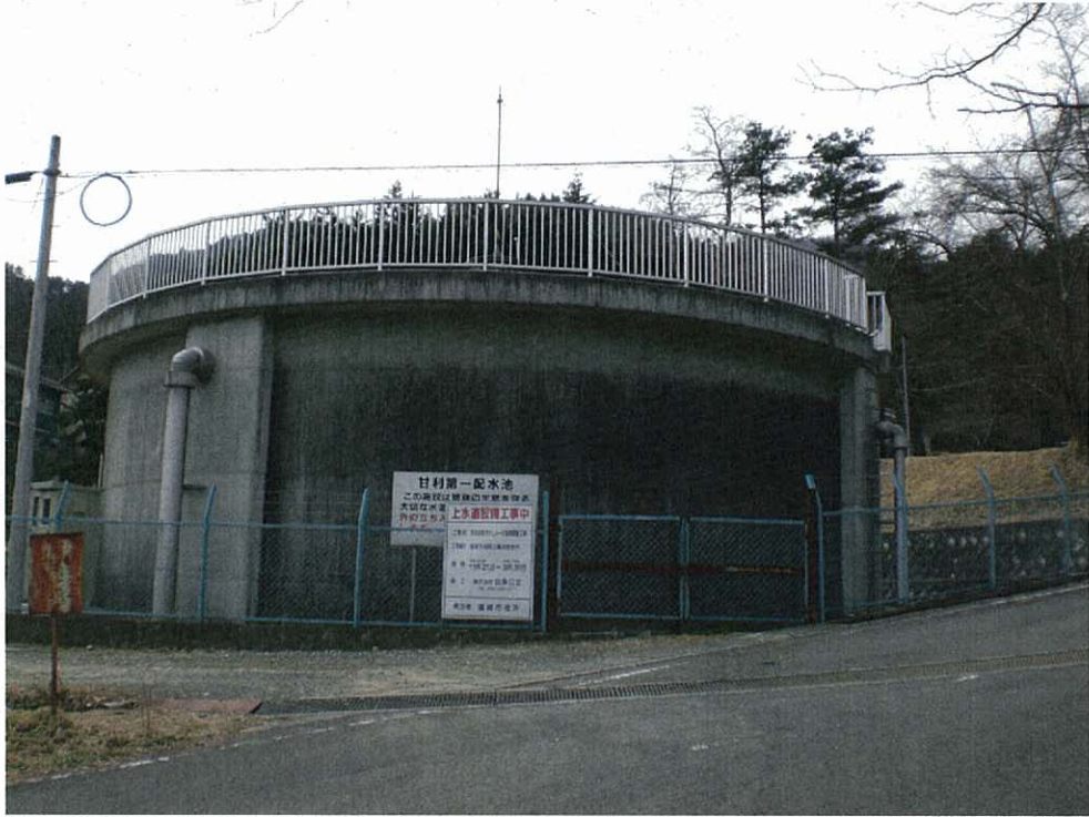
甘利第1配水池 (PC造り 容量=600m3)
