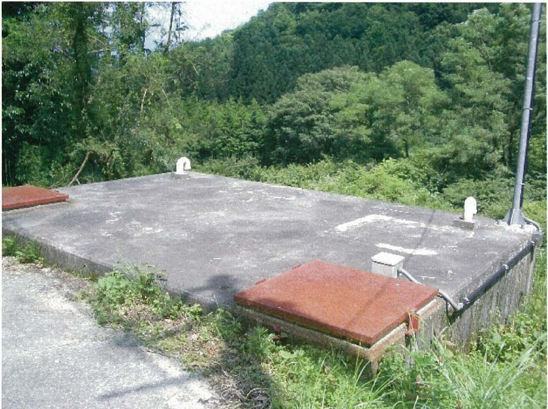
入戸野・下田井簡易水道 配水池
