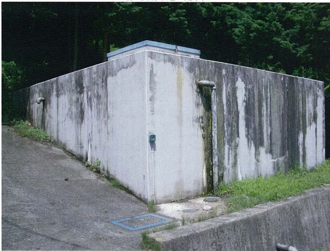
鍋山簡易水道 配水池
