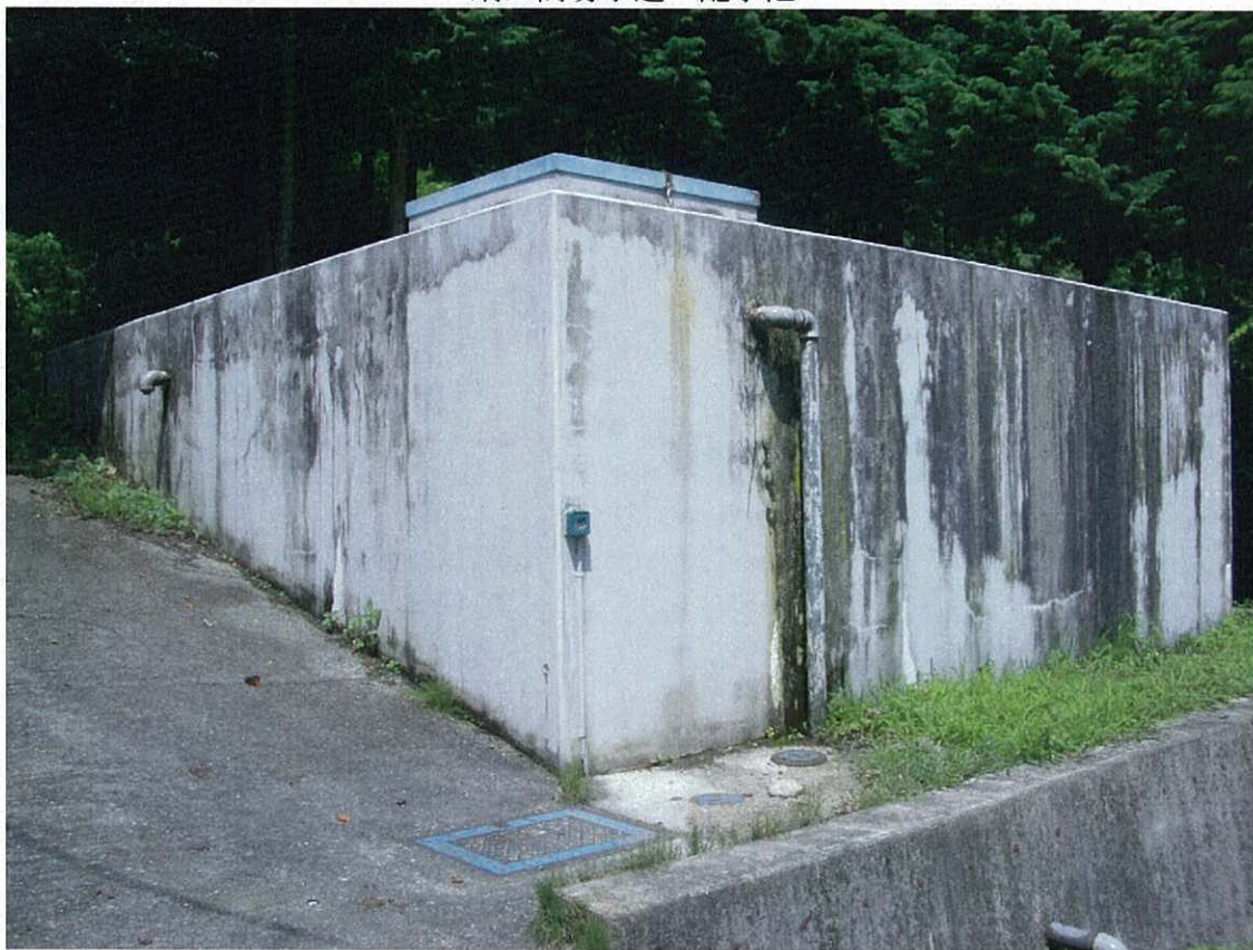
鍋山簡易水道 配水池
