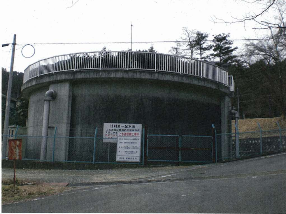
甘利第1配水池 (PC造り 容量=600m 3 )
