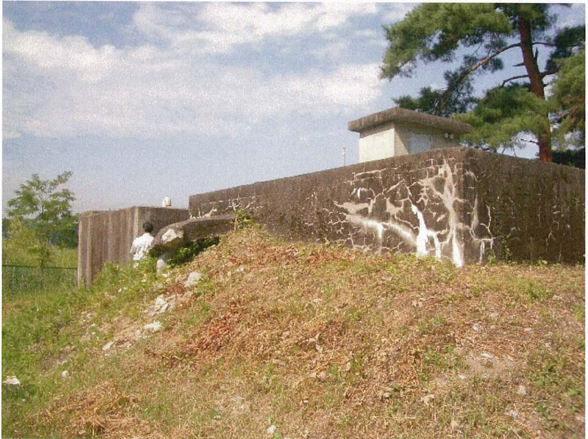
上円井簡易水道 配水池
