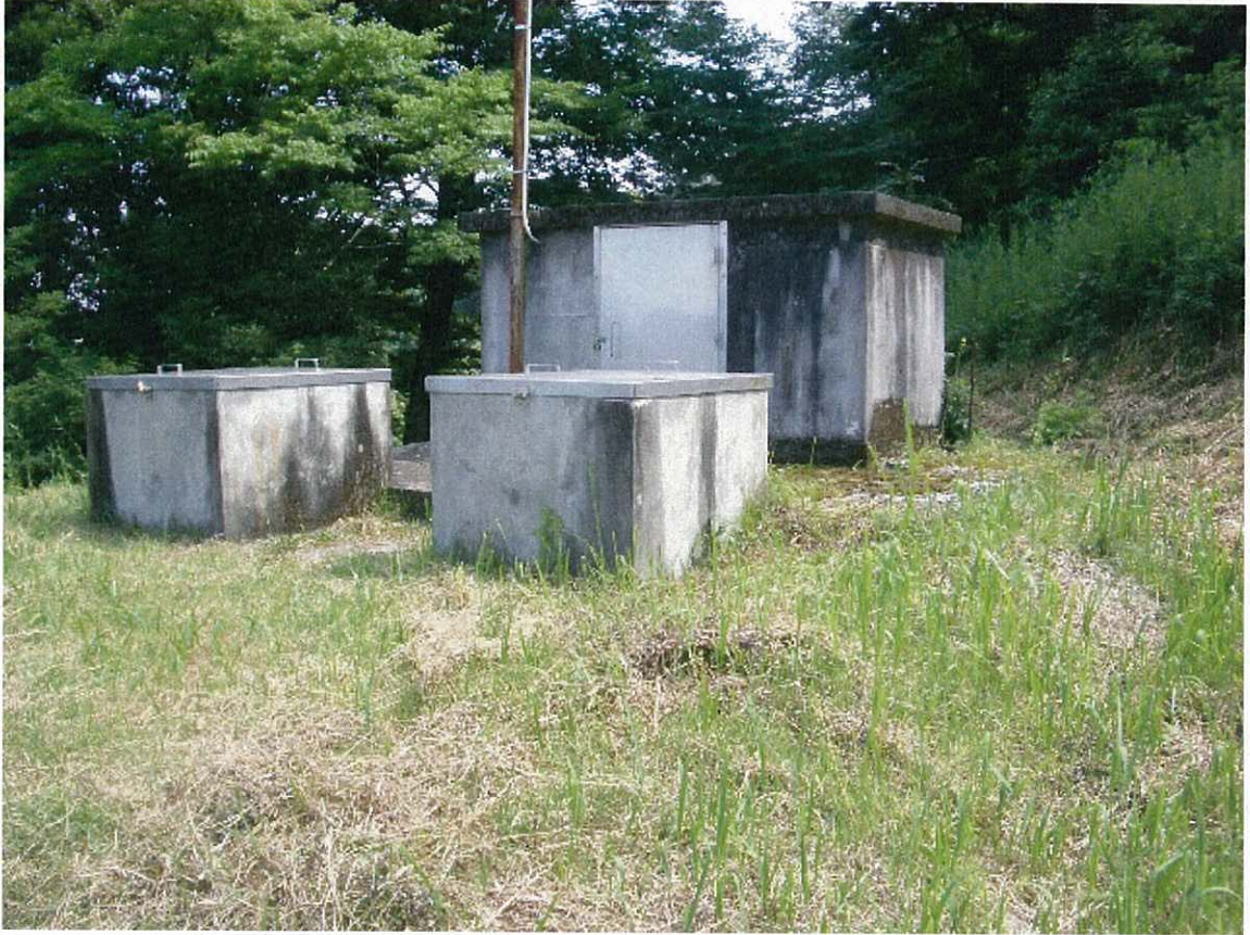
宇波円井簡易水道 配水池
