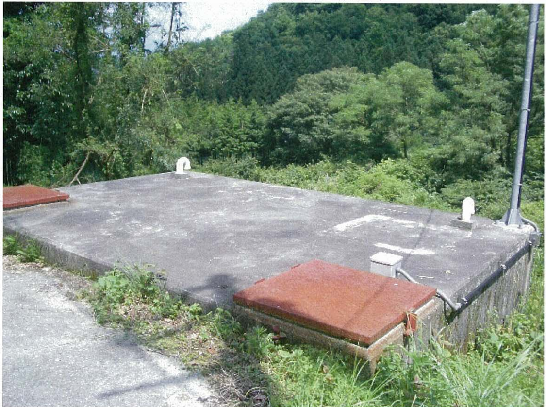
入戸野・下円井簡易水道 配水池
