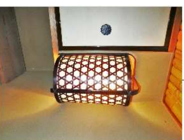
水屋「ツリカ」照明：既存i
