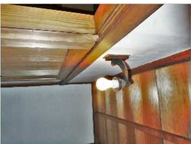
階段室「ツリカ」照明：既存f
