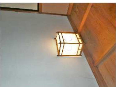
廊下「ツリカ」照明：既存g
