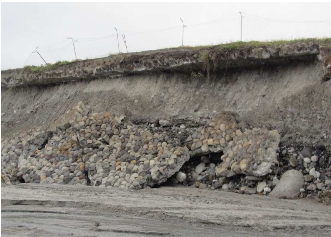
令和元年10月の台風19号による釜無川右岸の堤防洗掘（清哲町地内）
