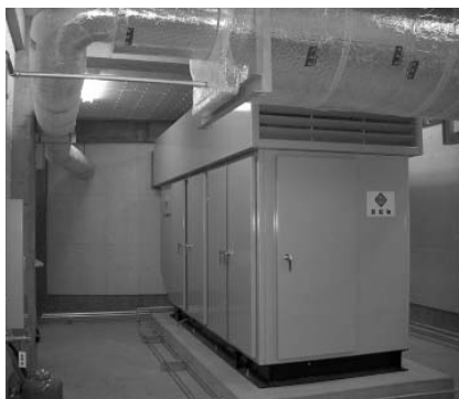
▶ 自家発電装置
