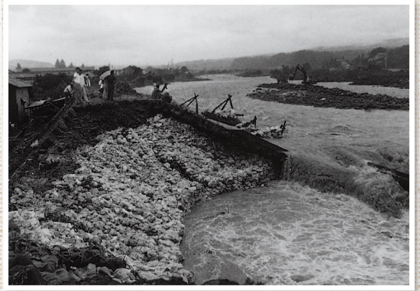
台風18号で塩川堤防が決壊 昭和57年(1982)9月
