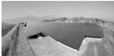
米倉山メガソーラー発電所 太陽光パネル (写真提供：山梨県)
